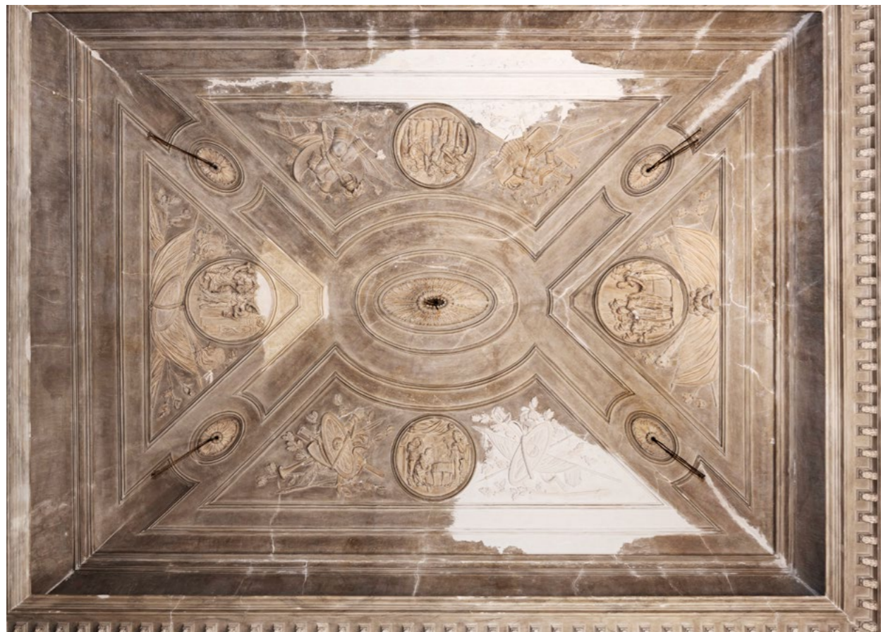
Rijeka, upravna zgrada bivše tvornice „Rikard Benčić“, Mramorna dvorana. Svod nakon završene rekonstrukcije nedostajućih dijelova, a prije retuša. Snimka: G. Tomljenović, 2019.
