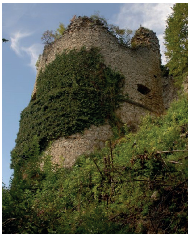
Kostel, Stari grad Kostel. Pogled na baterijsku kulu prije radova sanacije i rekonstrukcije. Fotografija: Vektra d.o.o., 2014.
