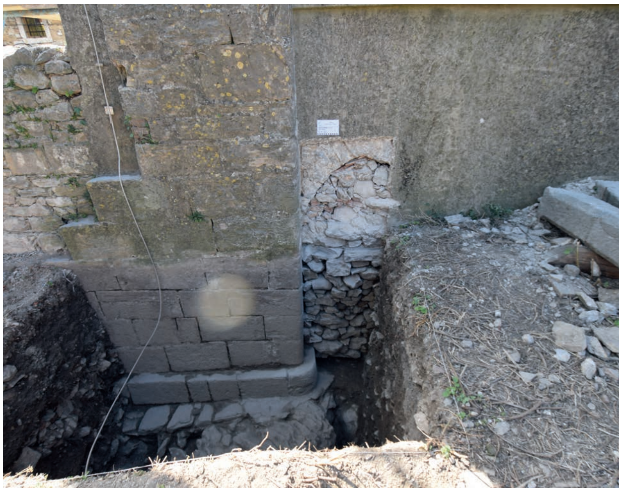
Labin, crkva sv. Justa. Probna arheološka i restauratorska sonda u kojoj je otkriven sjeverozapadni kut crkve i zazidani gotički portal zvonika. Fotografija: J. Višnjic, 2017.
