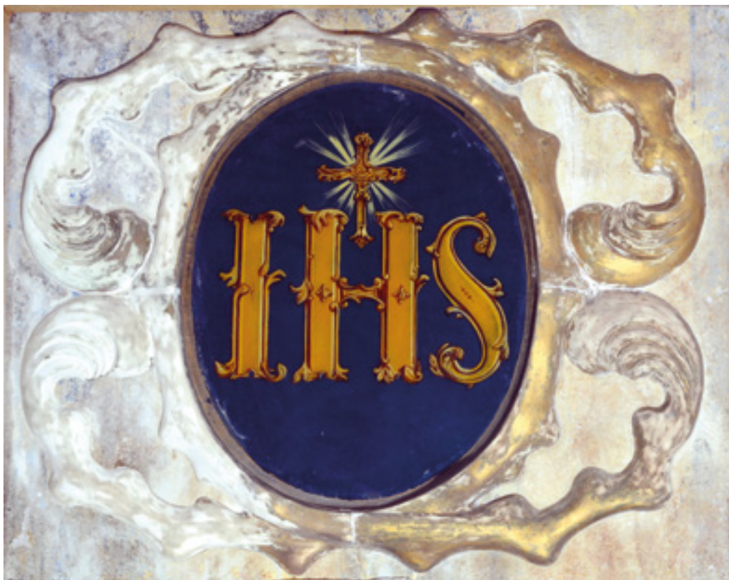
Dubrovnik, Biskupska palača, štuko-medaljon nakon odstranjenja naliča i zatvaranja oštećenja
