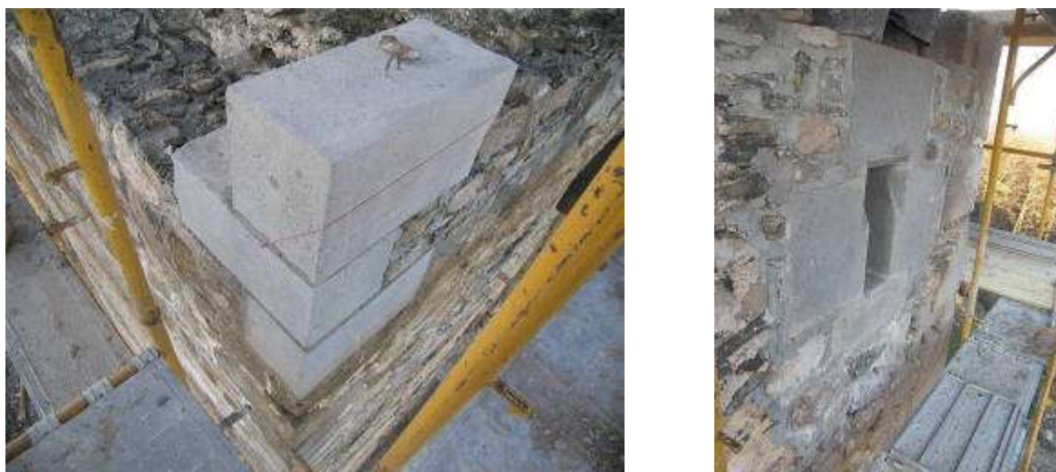
Slika 35. Podgarić, stari grad Garić-grad, lijevo - detalj zamjenskih uglovnjaka na sjevernom bridu kule, desno - rekonstruirani otvor na međupodestu stubišta na jugoistočnom zidu; blokovi su izvedeni betonom strukturirane površine
