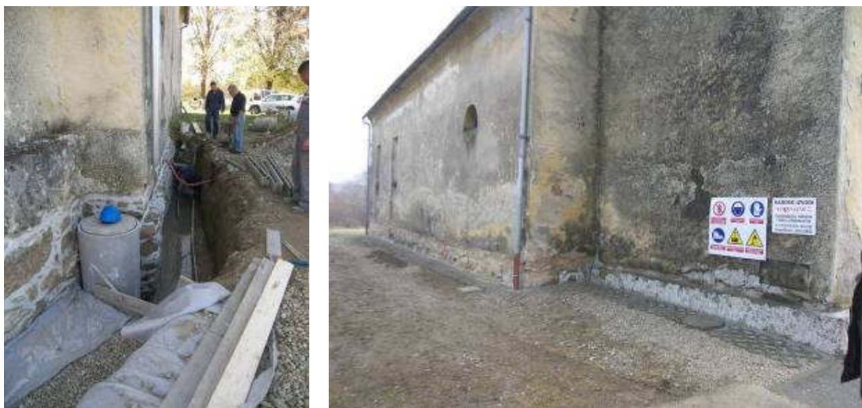
Slika 29. Veliki Poganac, SPC sv. Velikomučenika Georgija – izvedba drenaže i odvodnje krovnih voda uz sjeverno pročelje crkve (apsida, lađa i zvonik)
