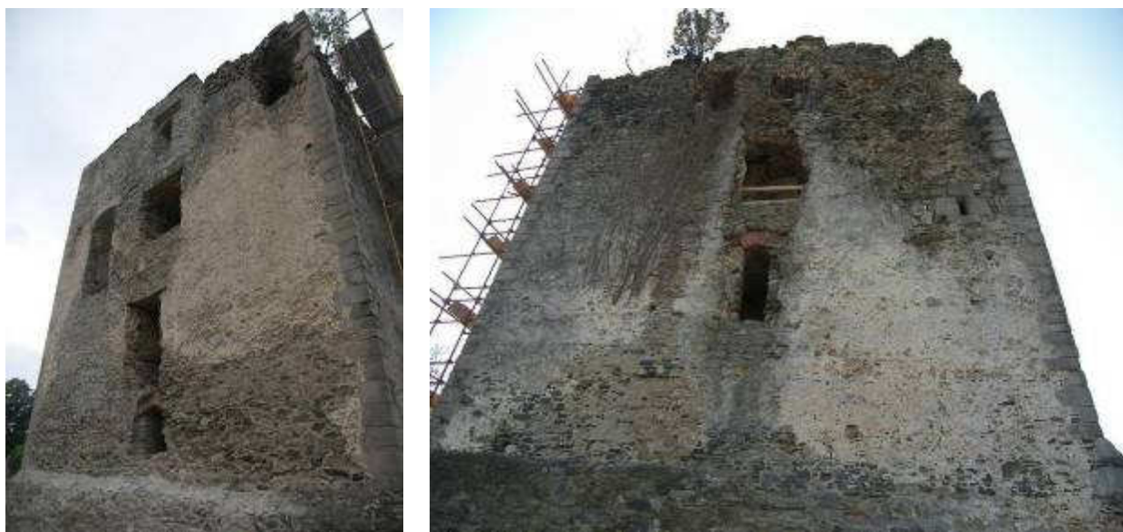
Slika 34. Podgarić, stari grad Garić-grad, stanje prije radova: lijevo - pogled na jugoistočni zid, desno - pogled na sjeveroistočni zid
