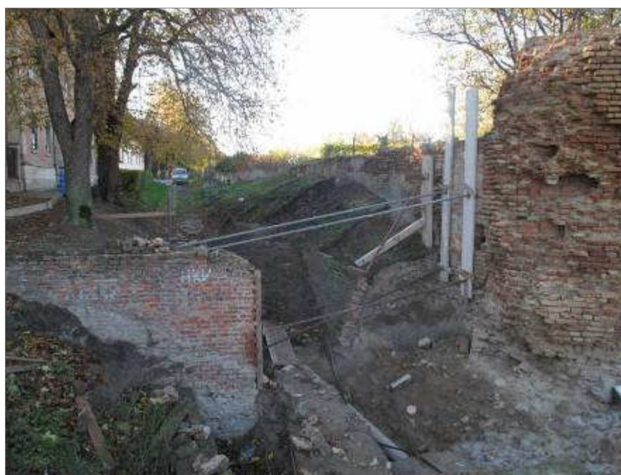
Slika 89: Ilok: radovi na konstruktivnoj sanaciji i prezentaciji peterokutne kule i istočnog ulaza u grad.
