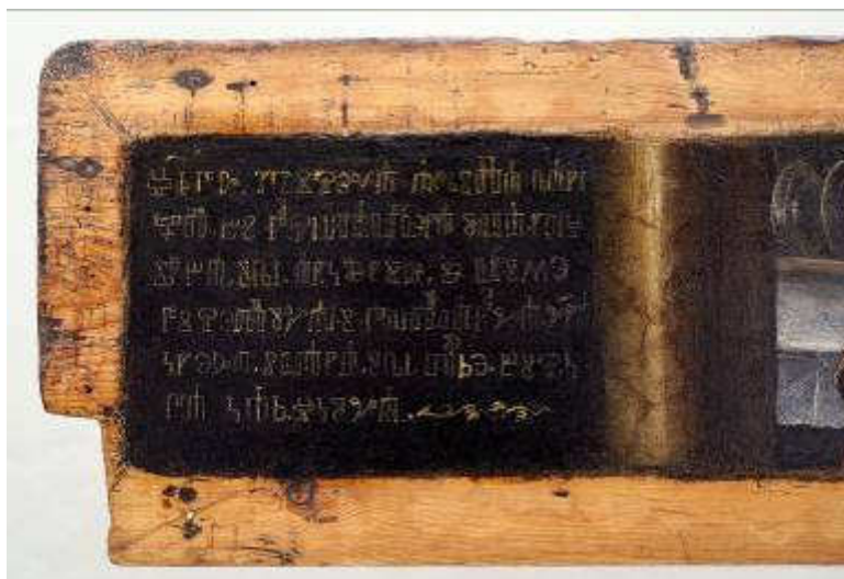
Slika 71: Vrbnik, ž. c. Uznesenja BDM, „Posljednja večera“, Marin Cvitković, 1599., detalj natpisa na glagoljici, stanje prije radova.
