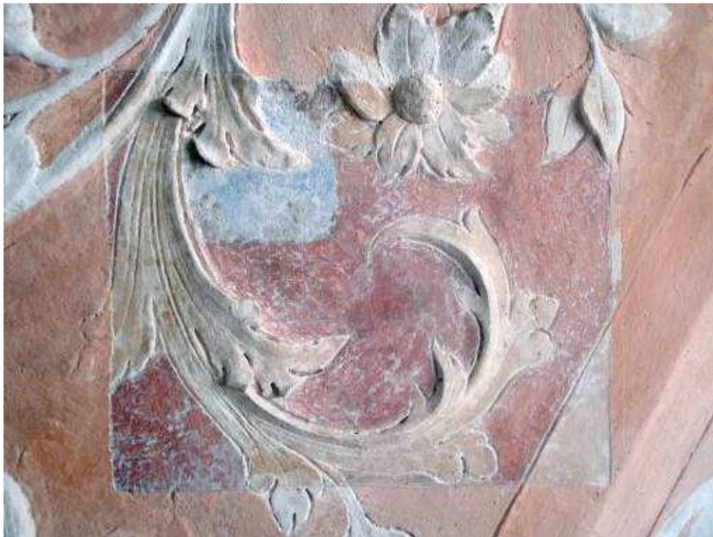
Slika 49: Lepoglava, predvorje bivše pavlinske crkve Sv. Marije, total stropa i detalj tijekom radova.
