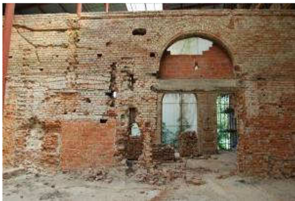
Slika 23: Lipik, Kursalon, stanje južnog zida zapadnog poprečnog krila prije početka radova.
