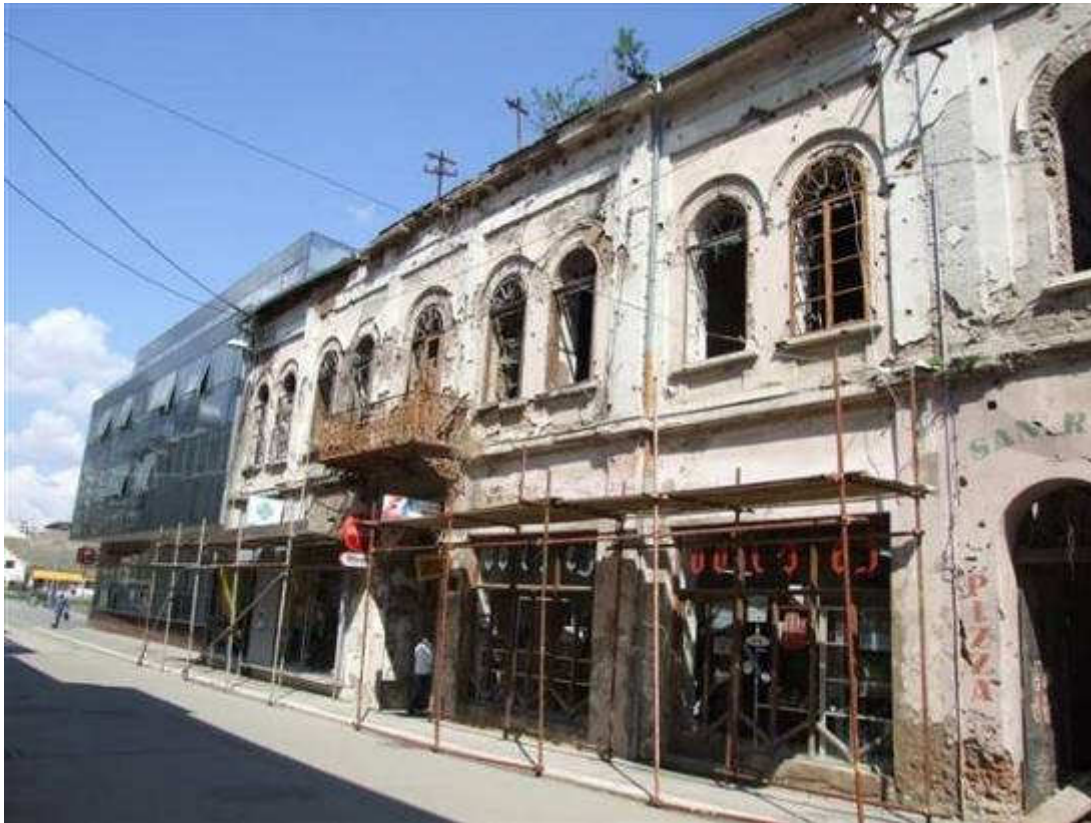
Slika 31.: Vukovar, pročelje u ratu oštećene rezidencije Paunović.
