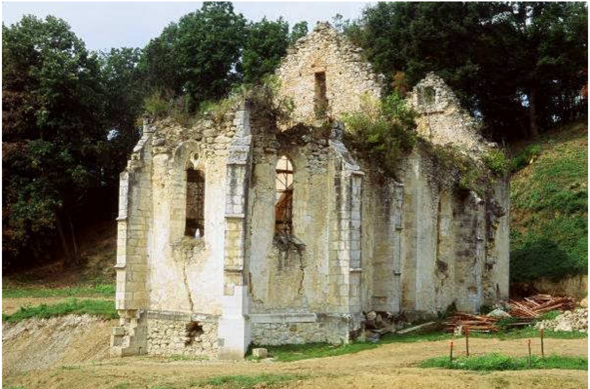
Slika 7.: Zrin, crkva sv. Marije Magdalene, pogled sa sjeveroistoka prije početka konstruktivne sanacije svetišta 2009. godine
