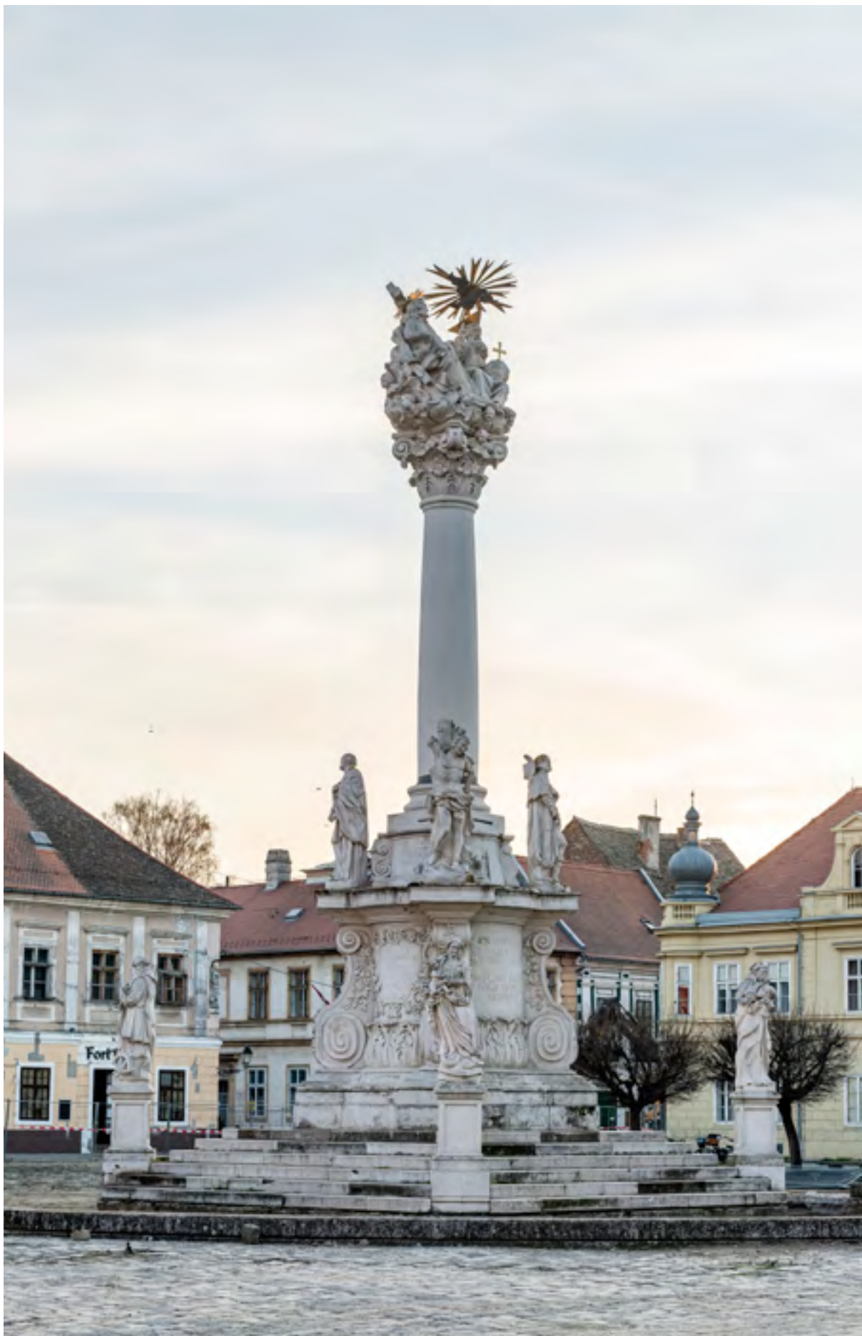
Osijek, Trg Presvetog Trojstva, kužni pil. Stanje prije radova. Snimka: I. Marinković, 2022.
