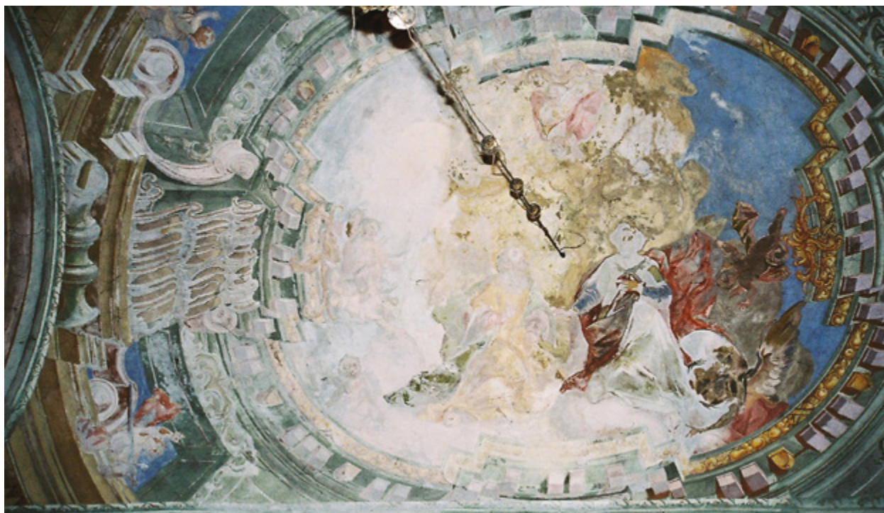
Kuzminec, crkva sv. Kuzme i Damjana. Zatečeno stanje svoda prvog traveja. Fotografija: A. Filip, 2015.
