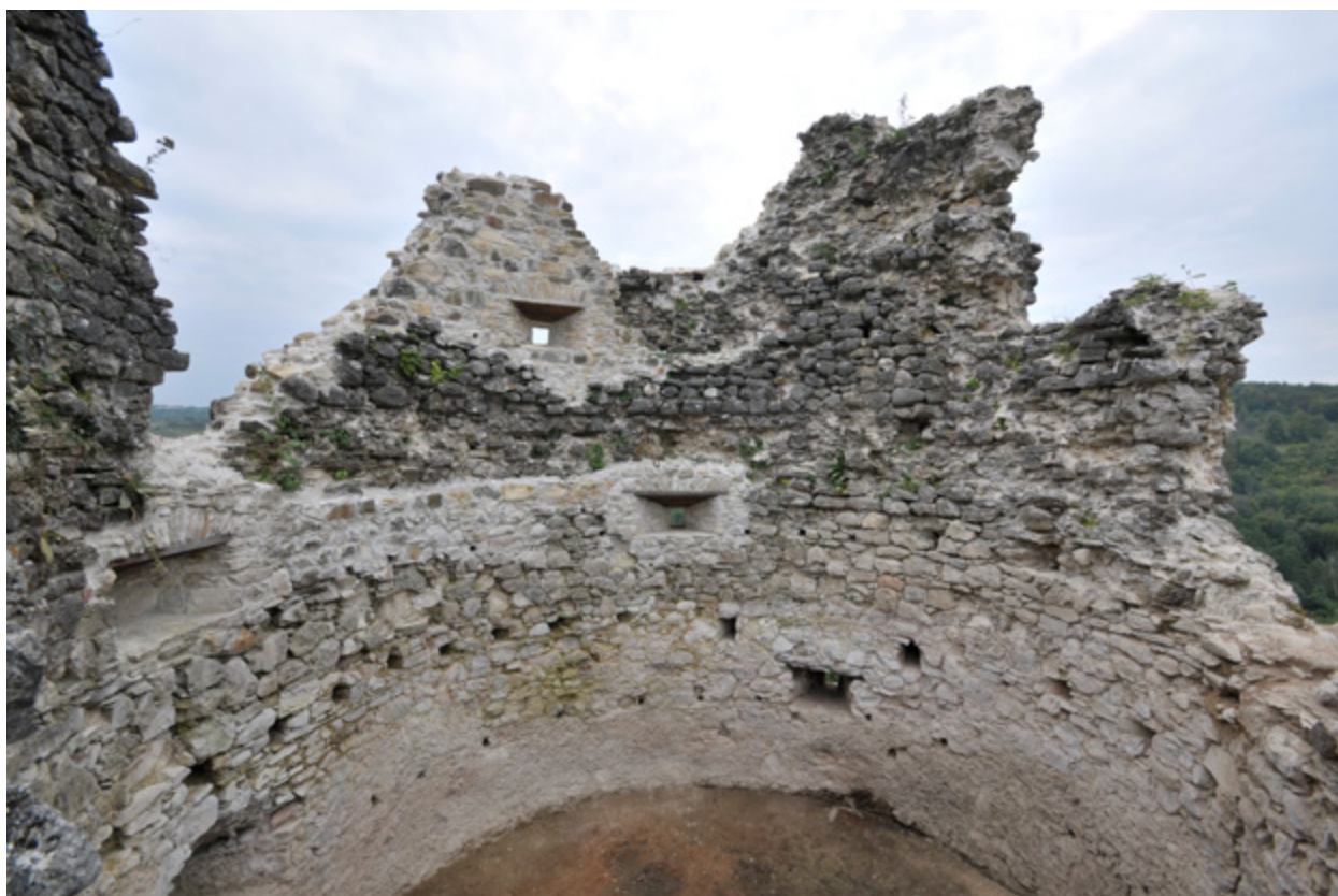
Hrvatski Čuntić, utvrda Čuntić. Pogled s istoka na zapadni dio zidnog plašta po dovršetku radova 2015. i 2016. godine. Fotografija: T. Pleše, 2015. i 2016.
