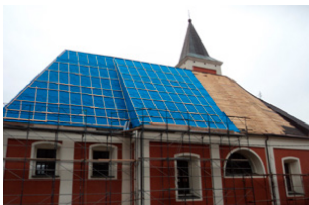
Kotari, crkva sv. Leonarda. Istočno pročelje crkve prije radova sanacije pokrova. Fotografija: A. Matanić, 2016.
