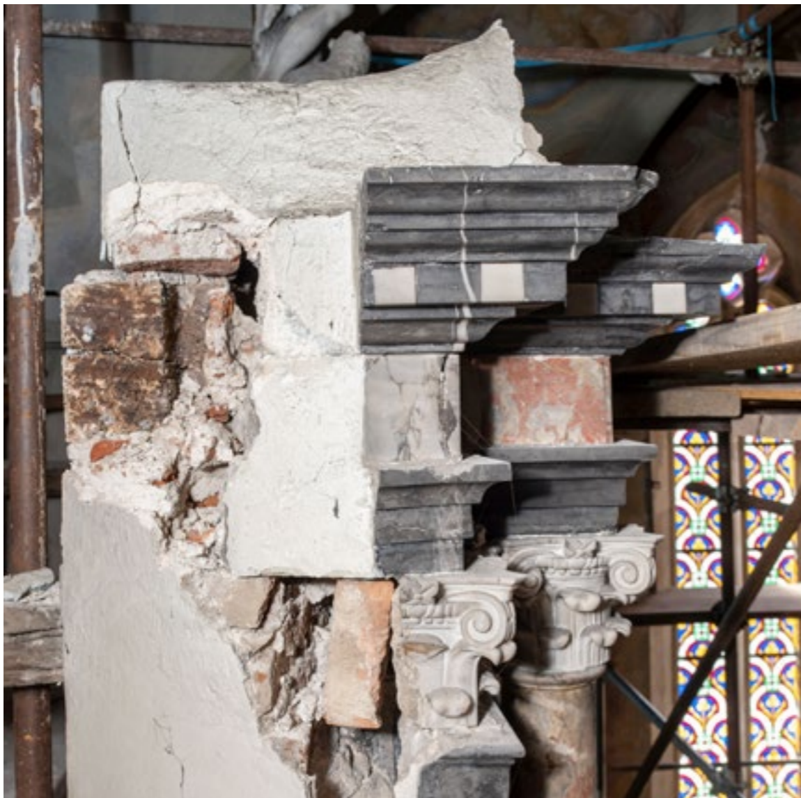
Zagreb, Remete, pavlinski samostan i župna crkva Uznesenja Blažene Djevice Marije, oltar Majke Božje Remetske. Oštećenja atike. Snimka: J. Kliska, 2021.
