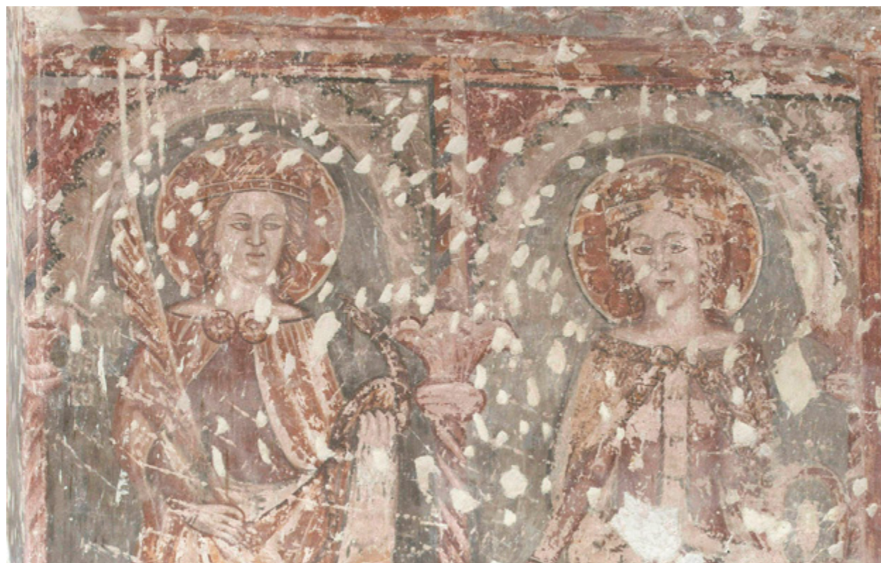
Slika 15. Požega, kapela sv. Lovre, južni zid lađe pred trijumfalnim lukom, stanje prije reintegracije i rekonstrukcije slikanog sloja
