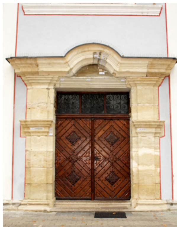
Slika 27. Slavonski Brod, franjevačka crkva i samostan Sv. Trojstva, portal na zapadnom pročelju crkve, stanje prije radova
